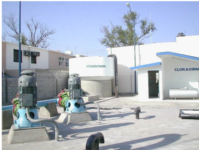
Figura 5. Cárcamo de bombeo, sedimentador y caseta de cloración de “Campaña II”
